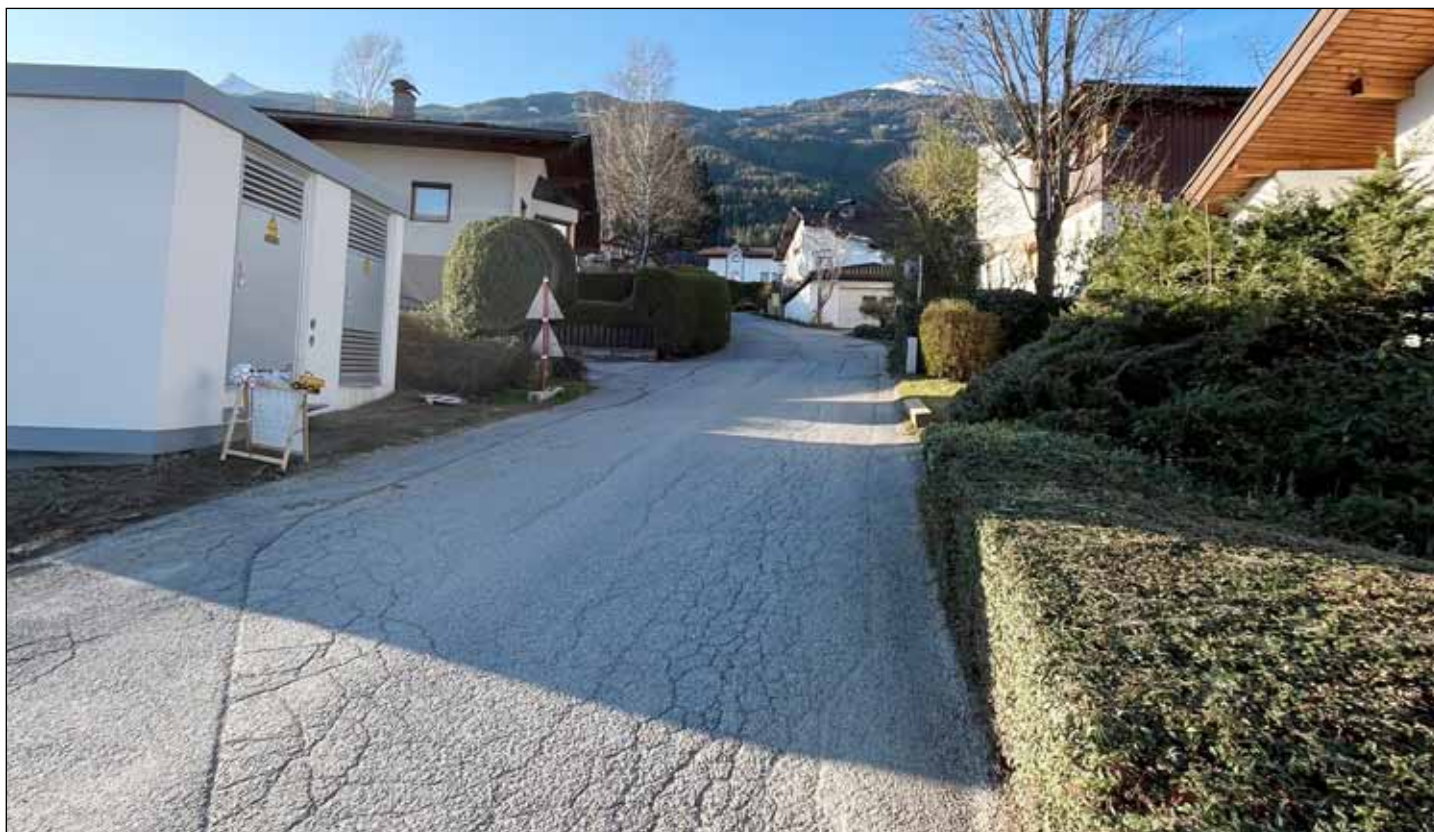
Der Perlachweg muss saniert werden. Links im Bild: die neue Trafostation © Gemeinde Sistrans
